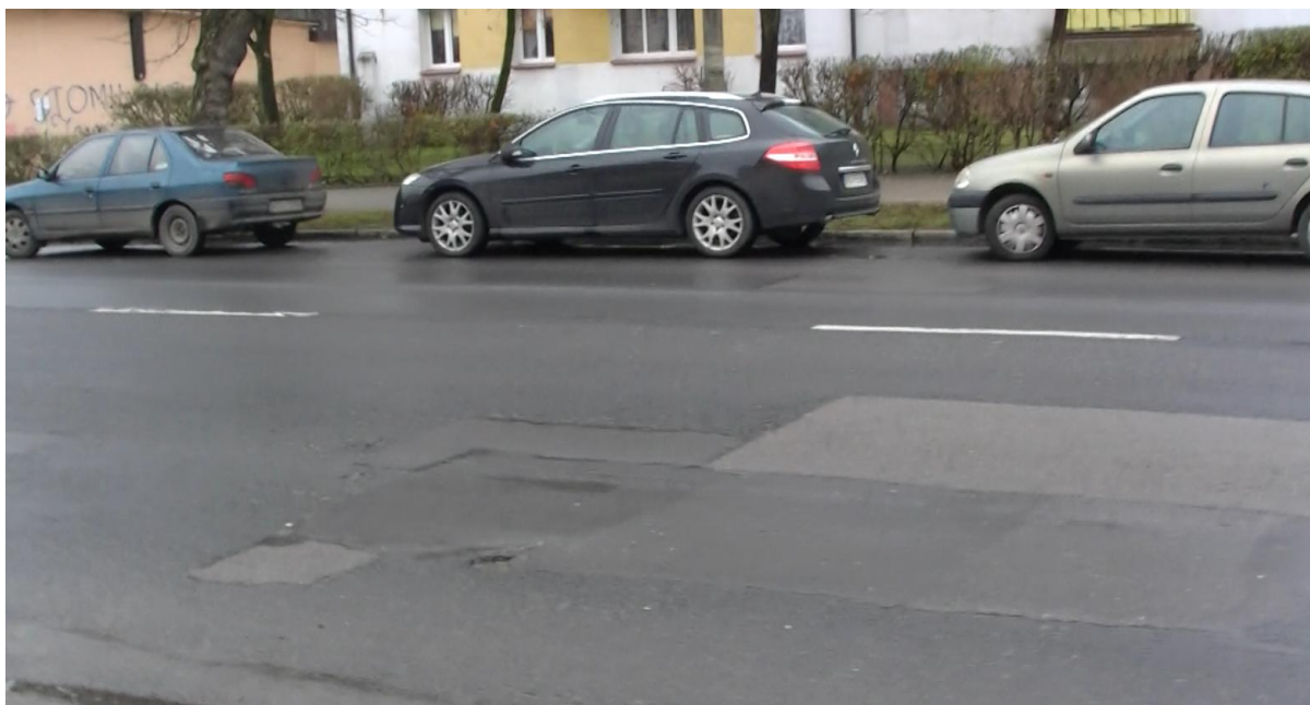
Zdj. 6. Ulica Wojska Polskiego – zły stan nawierzchni
