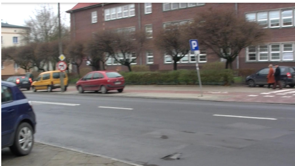
Zdj. 7. Ulica Wojska Polskiego – zły stan nawierzchni.
