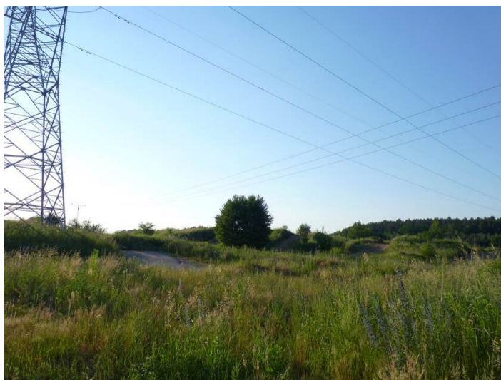
Zdjęcie. Istniejące linie elektroenergetyczne wysokiego i średniego napięcia w części wschodniej terenu objętego opracowaniem.
