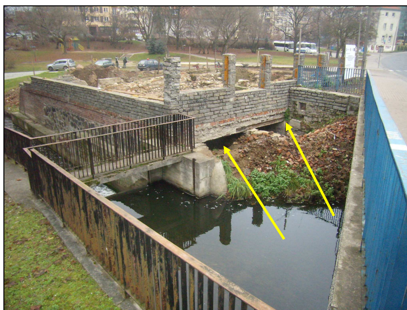
Fot. 1. Widok od strony ul. F. Nowowiejskiego na zasypane wejście do komór na turbiny
